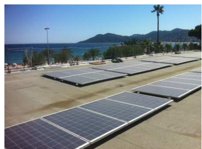
Centrale photovoltaïque Syndicat des Eaux à Cannes La Bocca (06)
