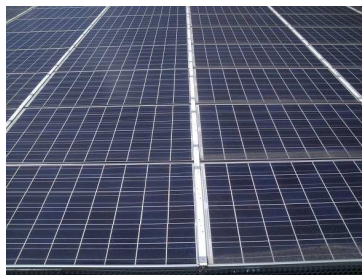
Centrale photovoltaïque STMT, dans les Bouches du Rhône
