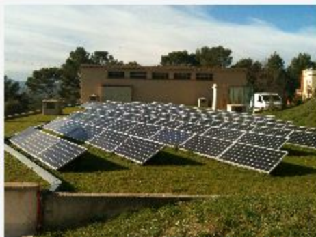
Centrale en sur-toiture du SICASIL
