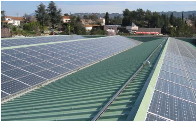
Mille mètres carrés de panneaux solaires en toiture
