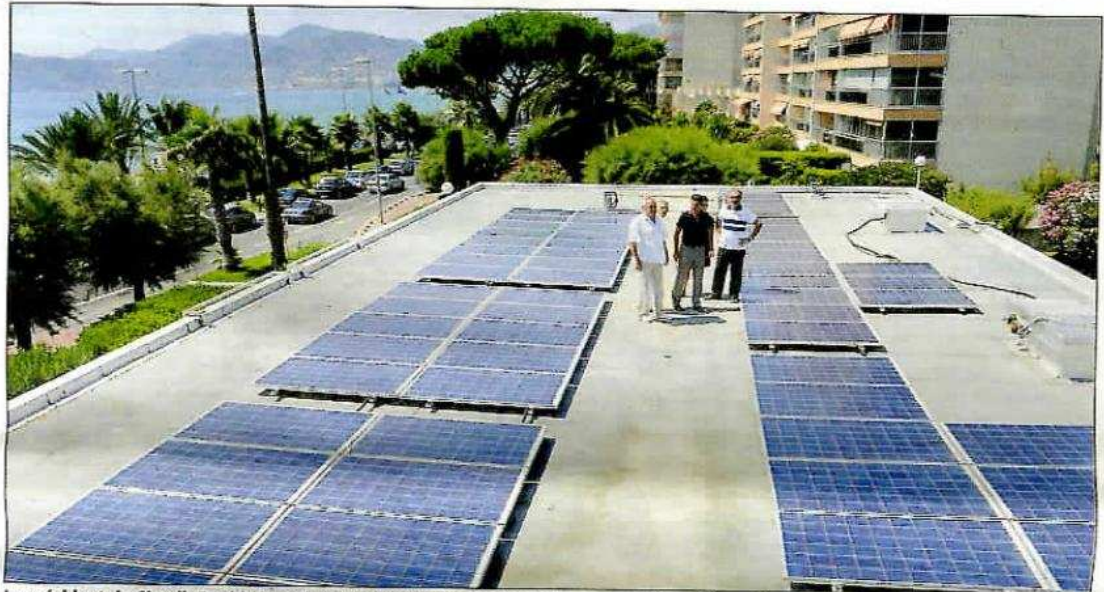
Le président du Sicasil, David Lisnard, et des représentants des communes membres du syndicat intercommunal de l'eau potable ont visité le chantier de pose de soixante-seize panneaux photovoltaïques sur le toit du siège, bd du Midi. (Photo Gilles Traverso)
